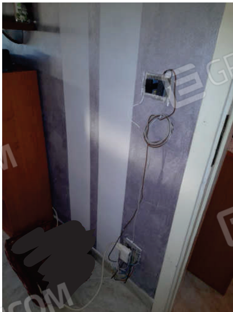
Foto 10: Particolare impianto elettrico privo di sicurezza
