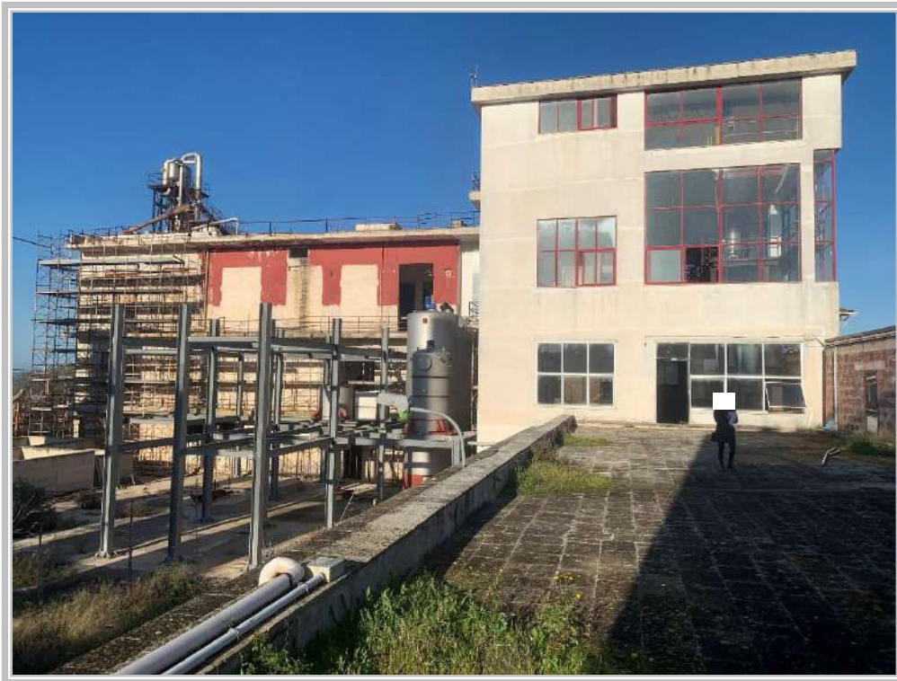
Foto n. 6 : Lotto 4 – Impianto di raffinazione.
