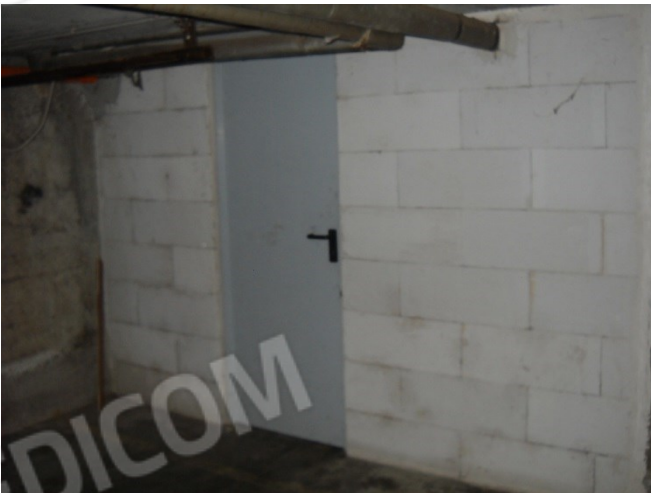
Posto auto coperto con muratura abusiva
