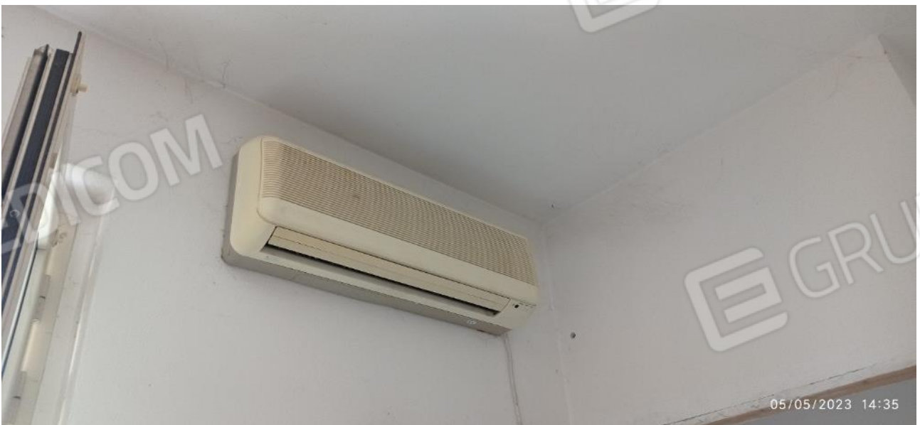
25. Unità interna pompa di calore
