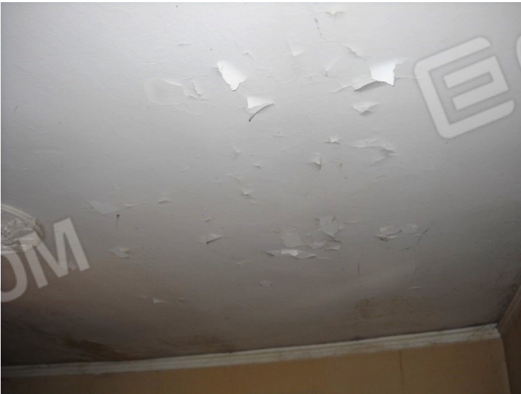
Soffitto ammalorato piano primo
