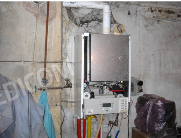
Caldia nel locale di sgombero piano terreno
