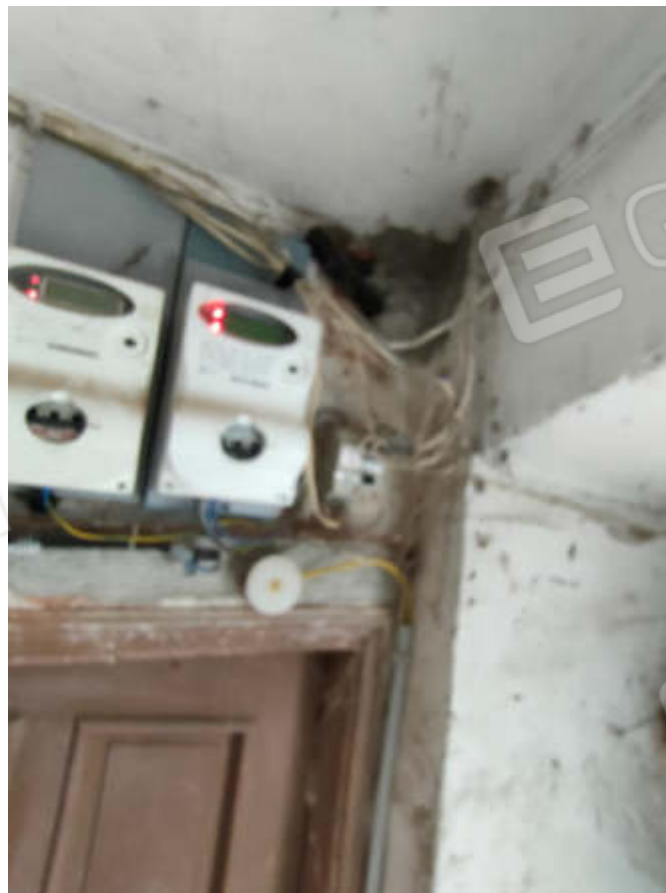
Contatore generale impianto elettrico, posto nell'ingresso comune in piano primo
