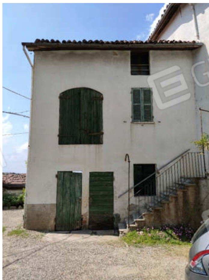
Vista dal cortile interno comune dei fronti Est e Sud del fabbricato oggetto di stima
