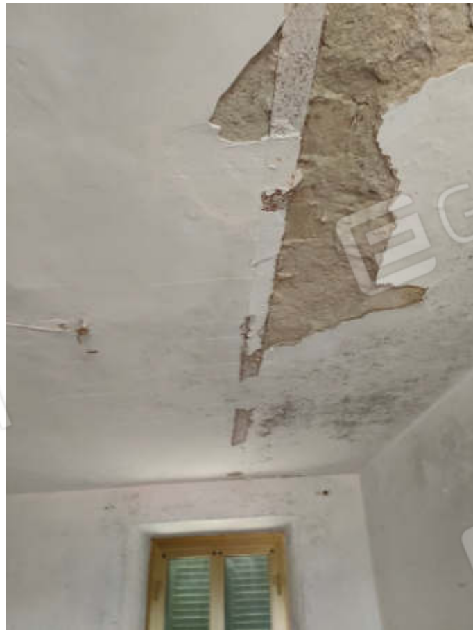
Vista situazioni di degrado ed ammaloramento intonaci locali in piano primo
