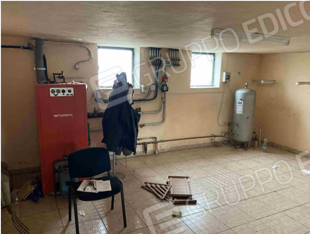
Foto 15 – Locale tecnico PT
