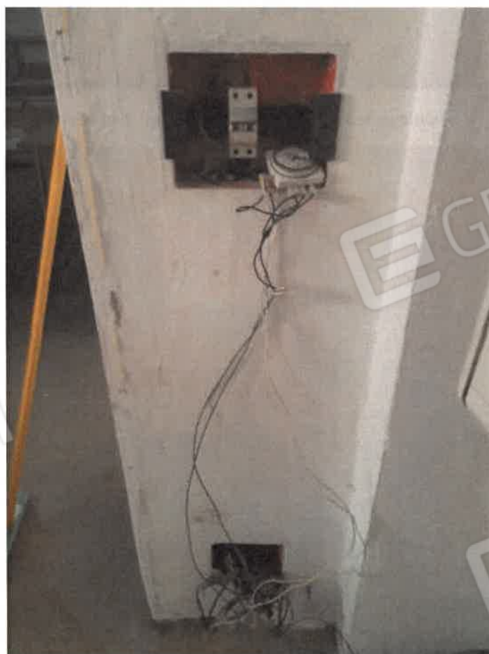
Impianto elettrico al momento dello accesso sui luoghi
