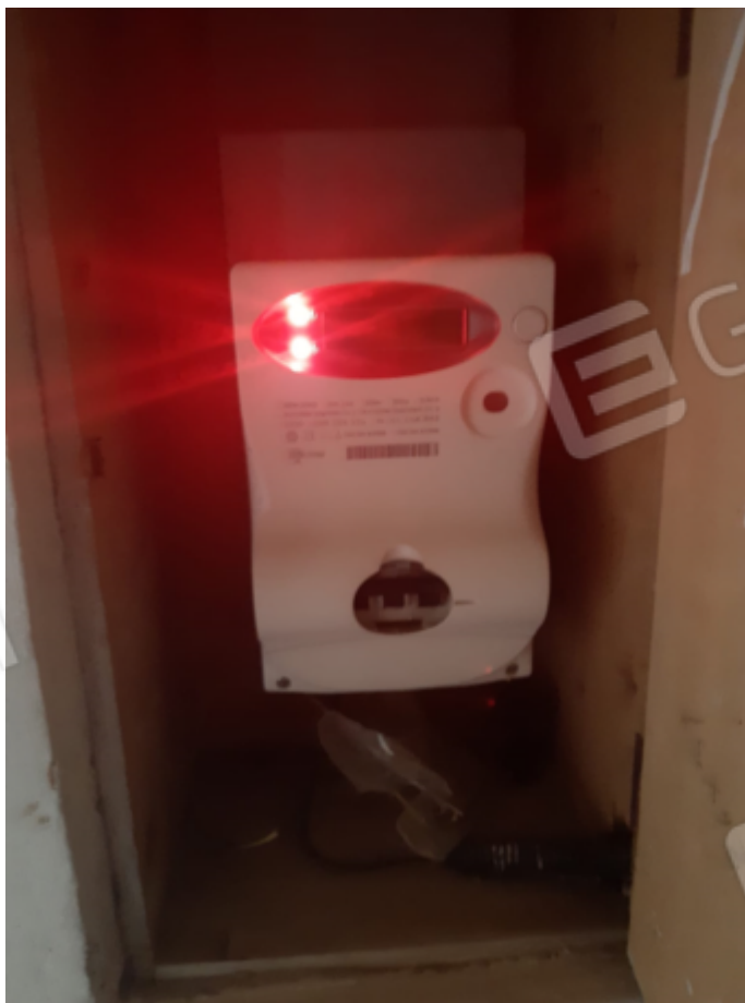
Vista quadretto elettrico generale di utenza e contatore impianto luce forza
