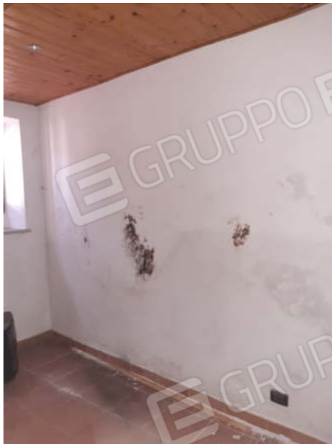
Vista delle situazioni di ammaloramento delle superfici interne verticali del locale soggiorno
