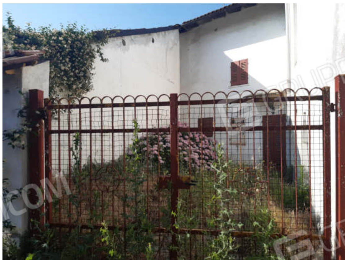
Vista esterna della porzione di cortile pertinenziale delimitata posta sul fronte Nord
