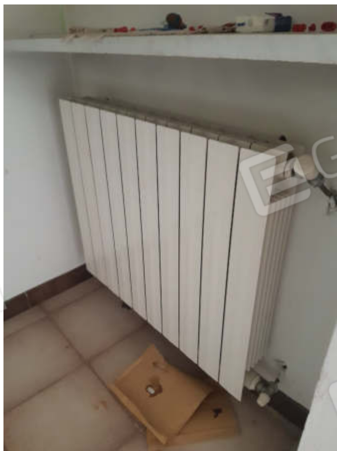
Vista generatore impianto riscaldamento e tipologia batterie termosifoni a servizio dei vani di abitazione
