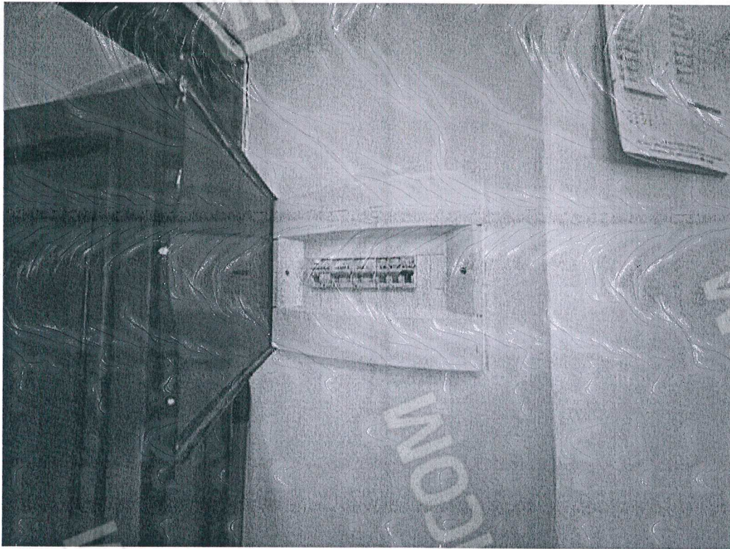
Figura 6 dettaglio impianto elettrico
