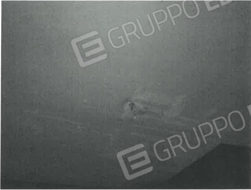
Foto n. 9_Soffitto della tavernetta, distacco di intonaco
