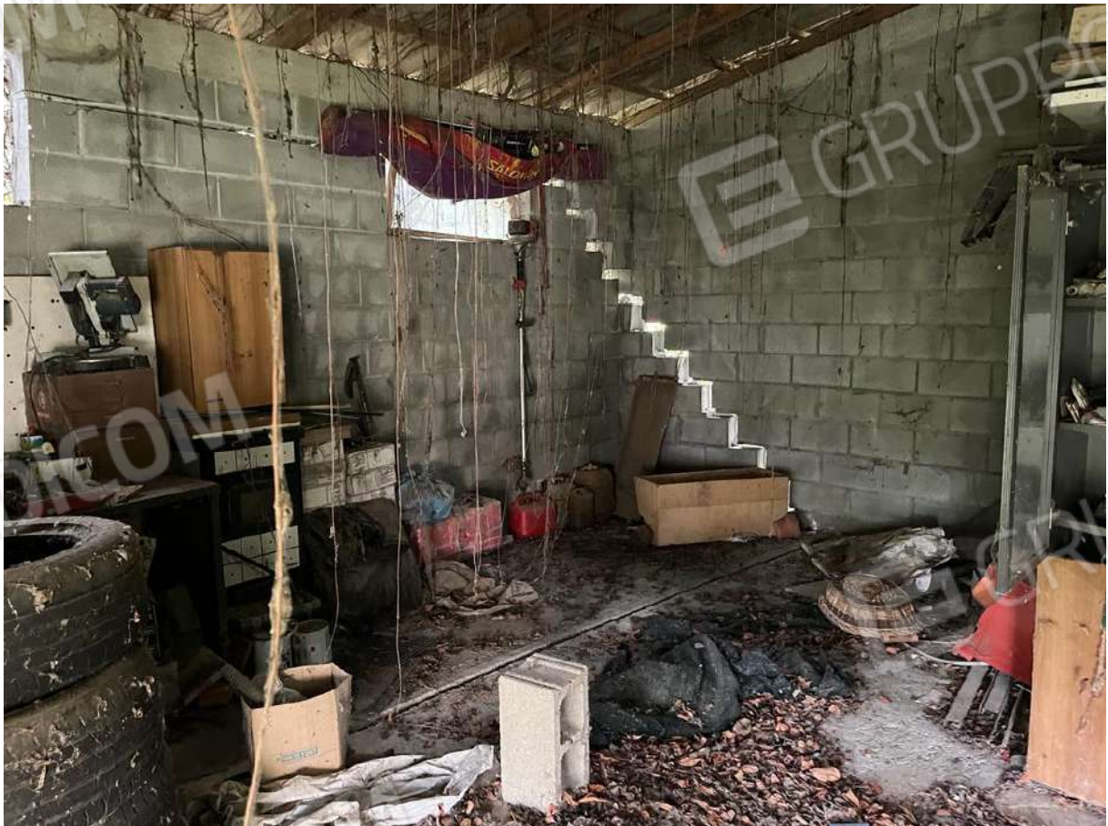
Fabbricato abusivo con particolare criticità
