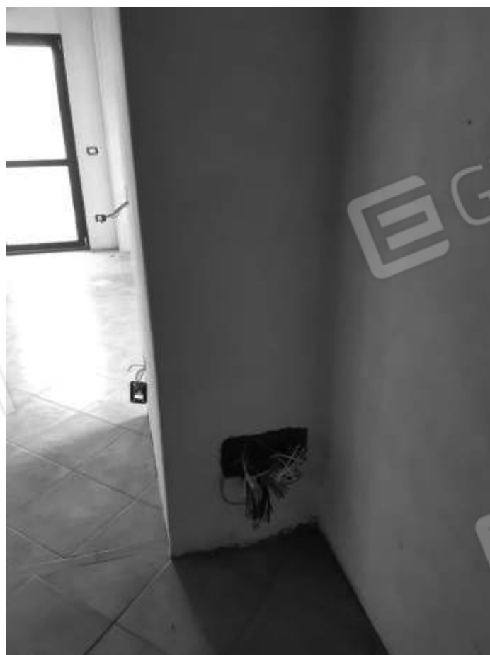
Vista interna alla U.I.U. – rifiniture disimpegno zona giorno / zona notte allo stato attuale
