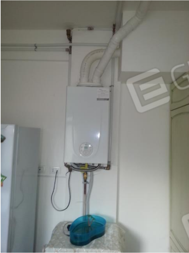
Foto 24 – Dettaglio caldaia e impianti subalterno 10
