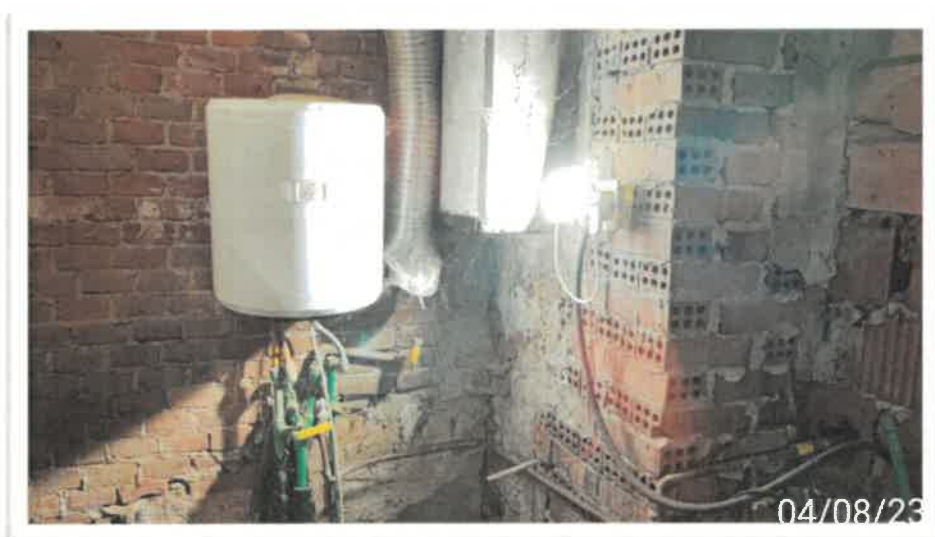
Sottotetto – Particolare boiler e caldaia non allacciata da sostituire
