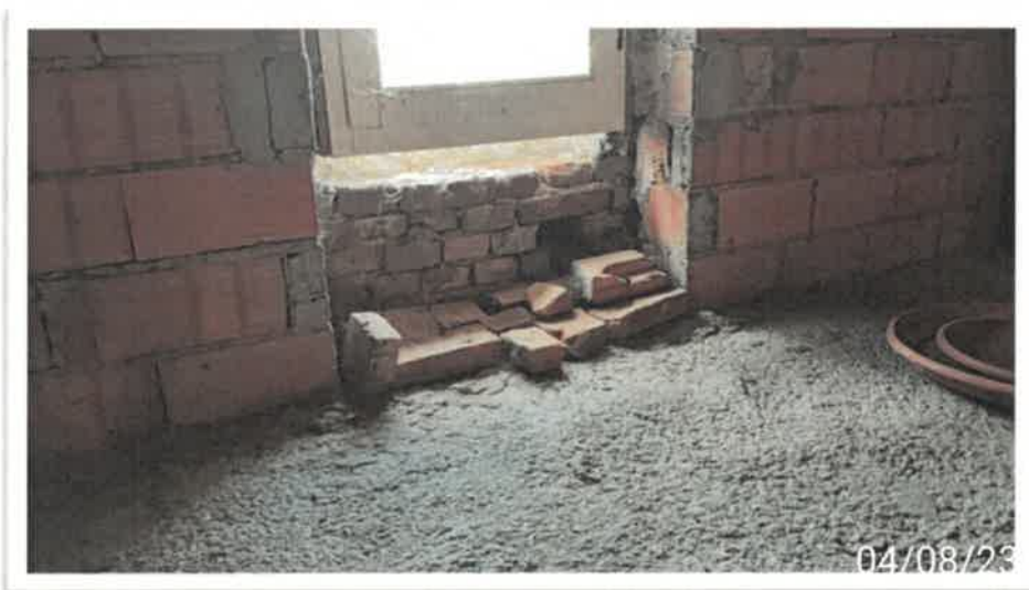
Sottotetto – Particolare infiltrazioni di acqua da serramento non sigillato
