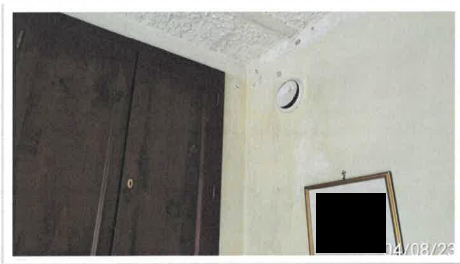
Camera da letto 2 – particolare tracce di infiltrazioni di acqua
