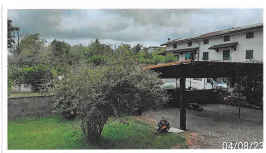
Tettoia ad uso ricovero auto da sanare
