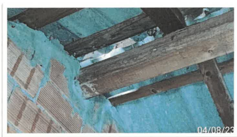
Sottotetto – Particolare infiltrazioni di acqua dal tetto causa coppi danneggiati e mancanza di scossaline
