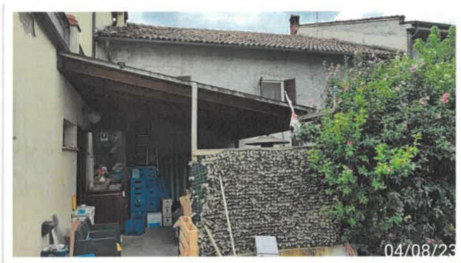
Tettoia su cortile posteriore da sanare
