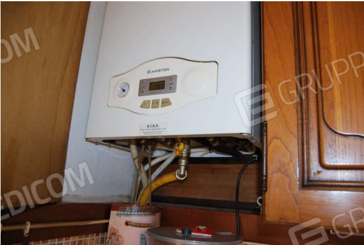
Cucina e caldaia a metano foto 9-10)
