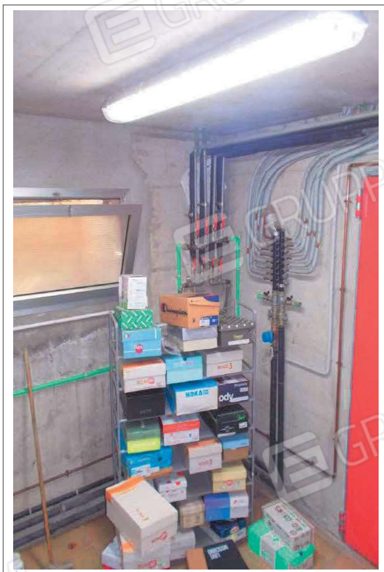
Fotografia n. 29 = LOTTO 2 Vista interna del locale caldaia al piano interrato
