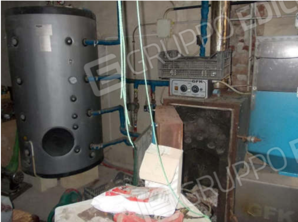
Foto 27 Locale di sgombero c.t. piano terra (particolare caldaia non funzionante)
