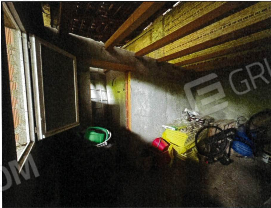
Immagine 44: Divisioni nel portico non ultimate
