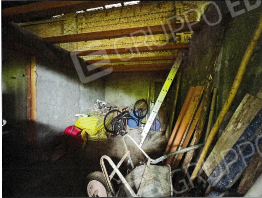
Immagine 43: Divisioni nel portico non ultimate
