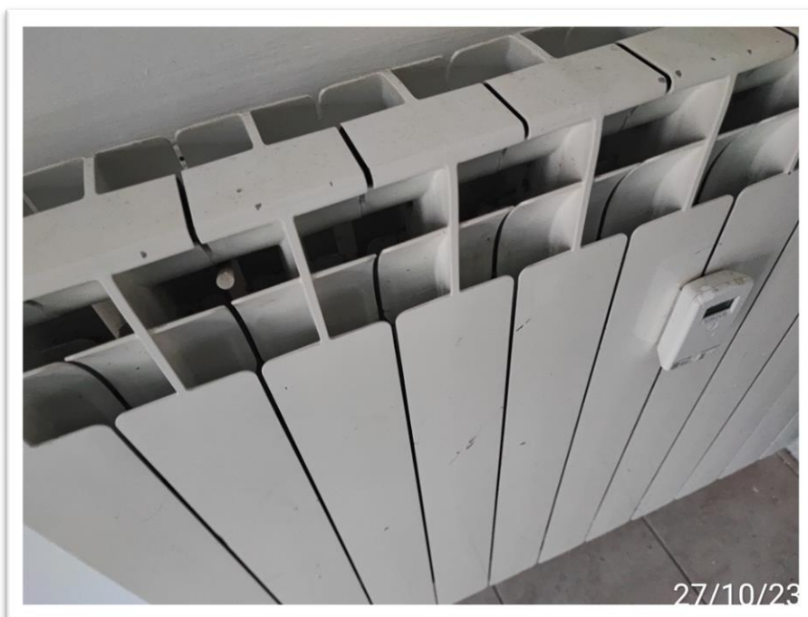
Particolare radiatore in alluminio con contabilizzatore di calore
