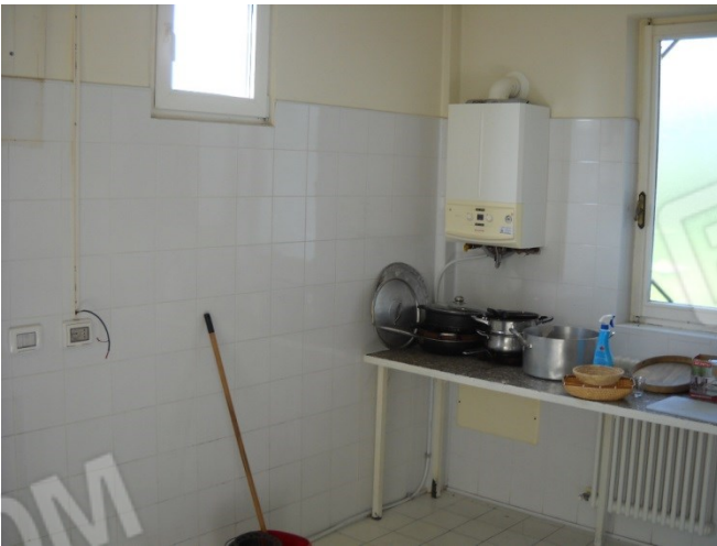
Locale commerciale retro con caldaia (sub.34)
