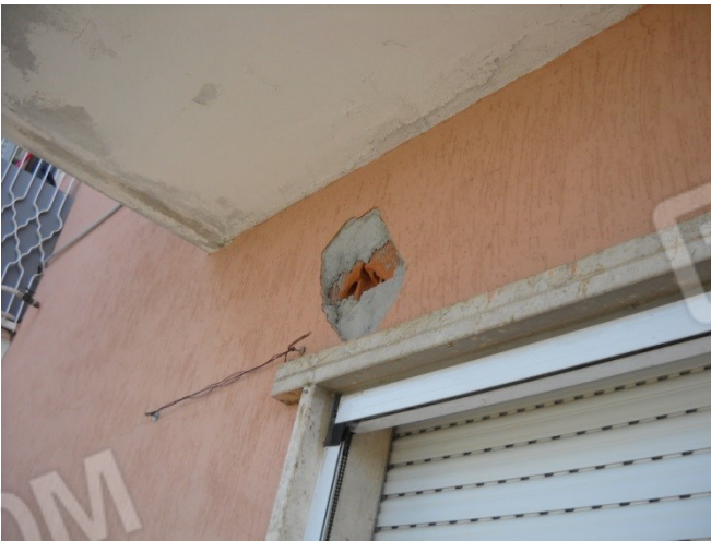
Distacco sopra portafinestra cucina
