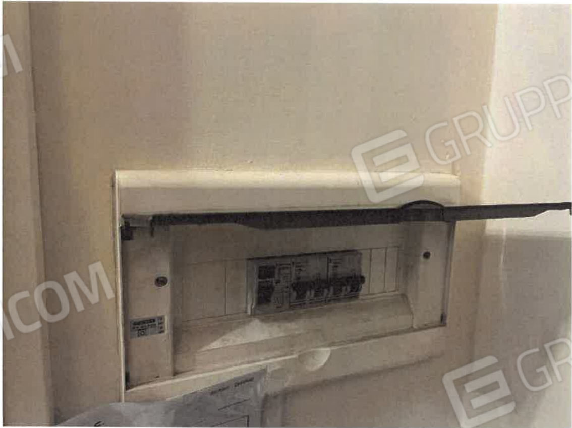
Figura 18 particolare impianto elettrico
