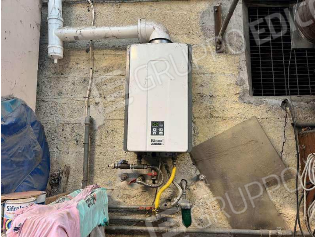
Figura 23 scaldabagno ubicato nella tettoia
