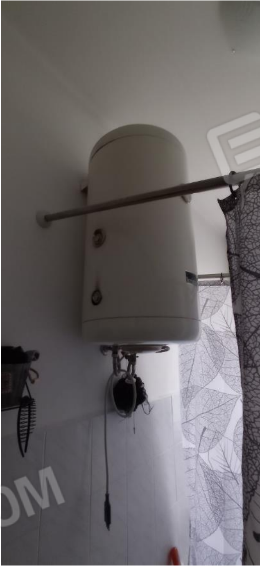
20. Bollitore acqua calda sanitaria
