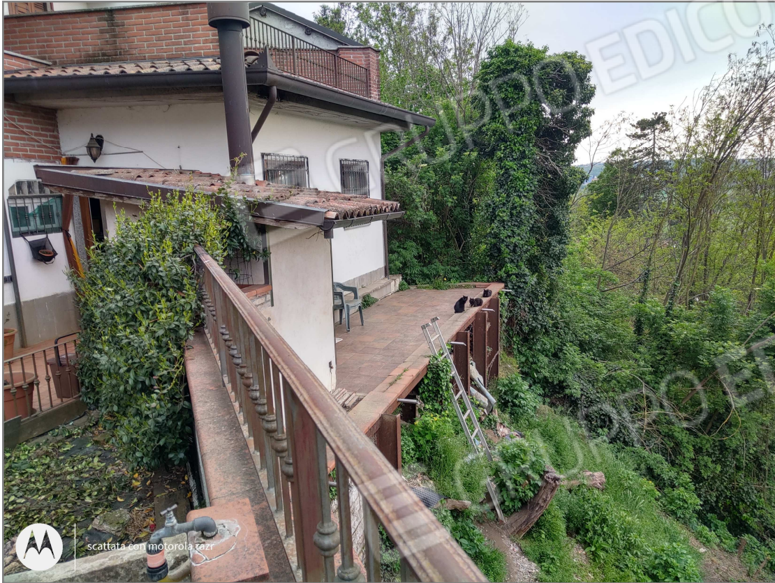
Vista su costruzioni interne al cortile e opere di terrazzamento a sostegno del fabbricato, insistenti su mappali 1151 e 264 [opere prive di autorizzazione edilizia]
