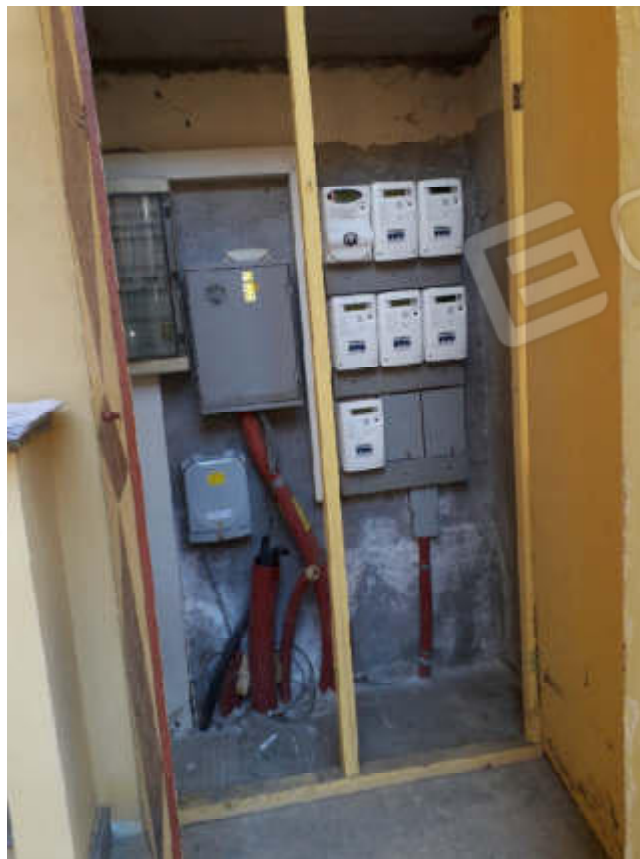
Vista particolare del quadro elettrico condominiale
