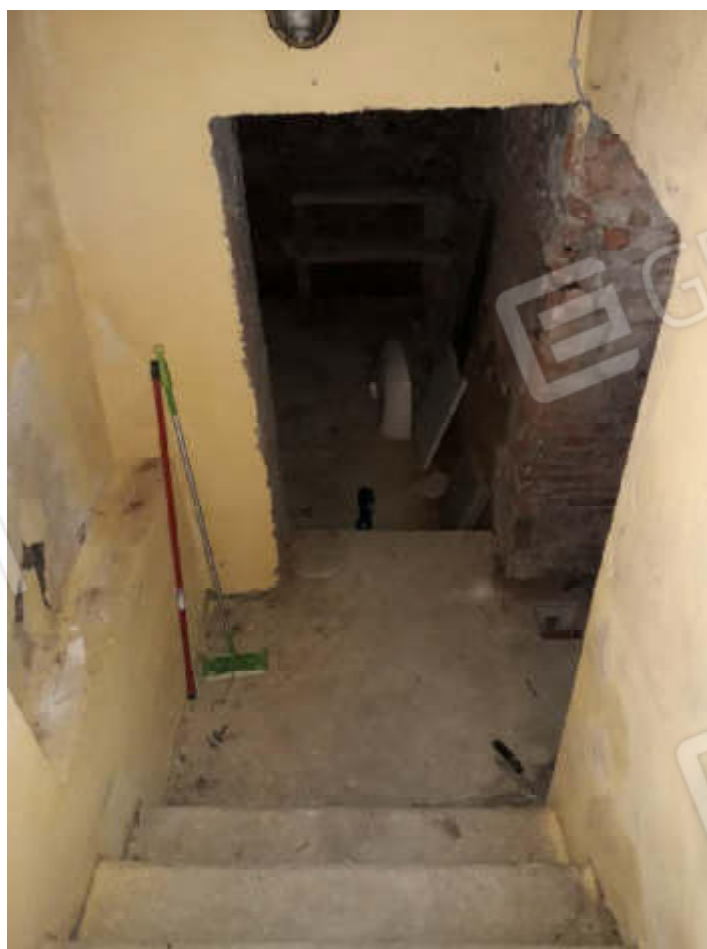
Vista scala di accesso interna di accesso ai locali pertinenziali destinati a cantina posti in piano primo sottostrada
