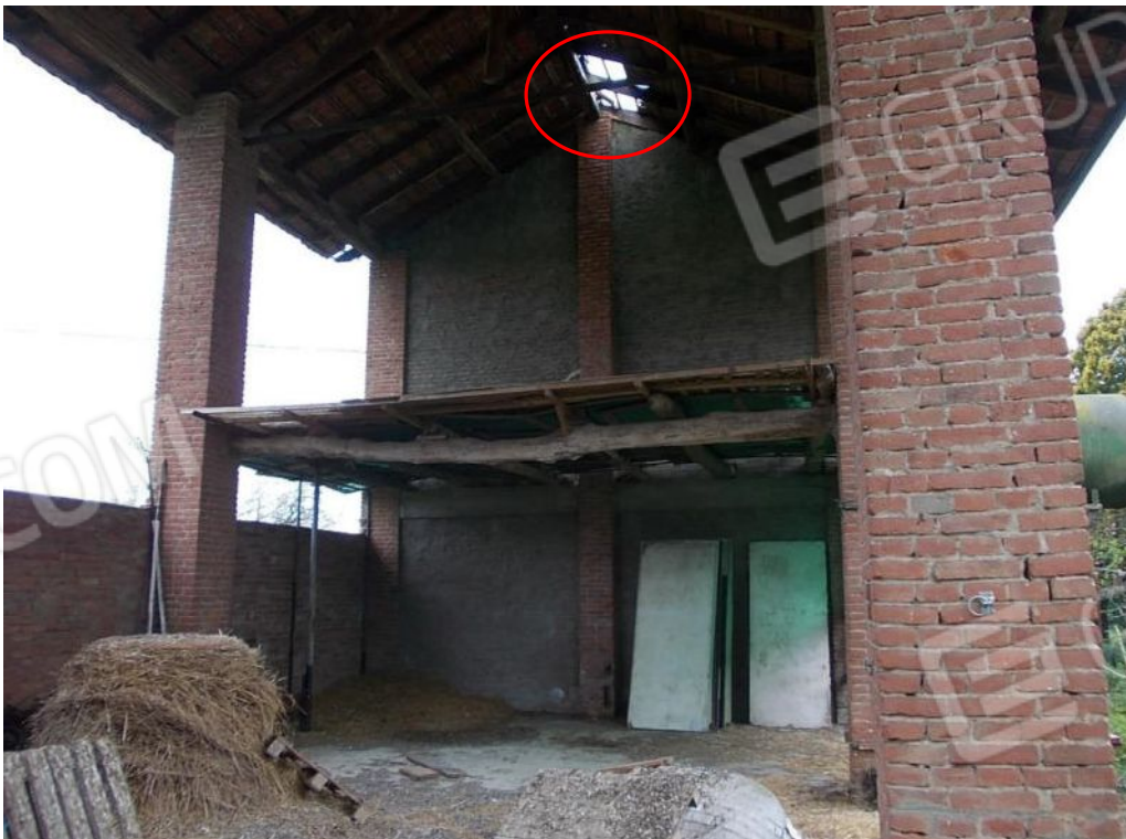
Foto 36 Tettoia con porzione di tetto crollato mapp.336 sub.4 p.t.
