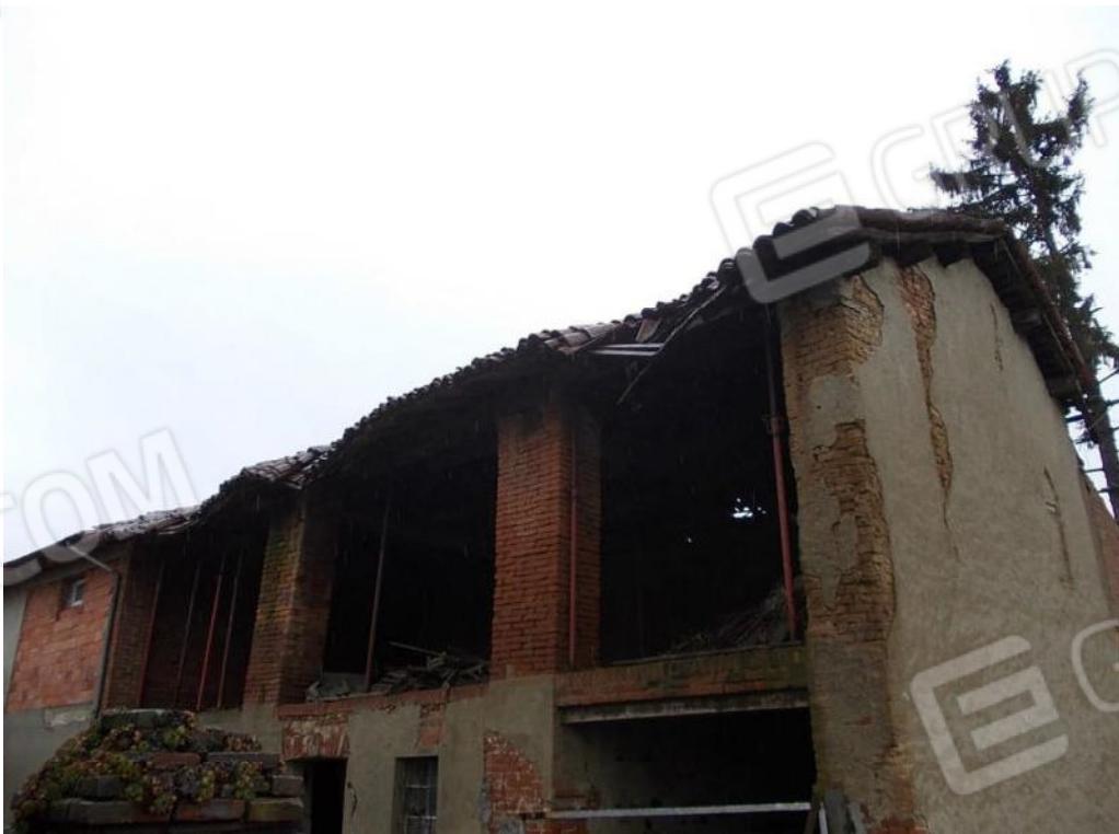
Foto10 Prospetto sud/ovest fabbricato collabente mapp.336 sub.3 locali sgombero (ex rurali)
