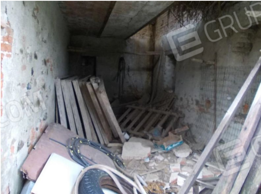
Foto 34 Locale sgombero collabente (ex rurale) mapp.336 sub.3 p.t.
