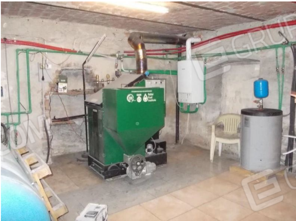
Foto 20 Centrale termica abitazione mapp.336 sub.2 p.t.
