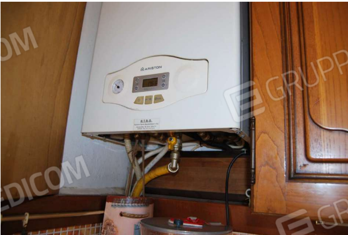
Cucina e caldaia a metano foto 9-10)
