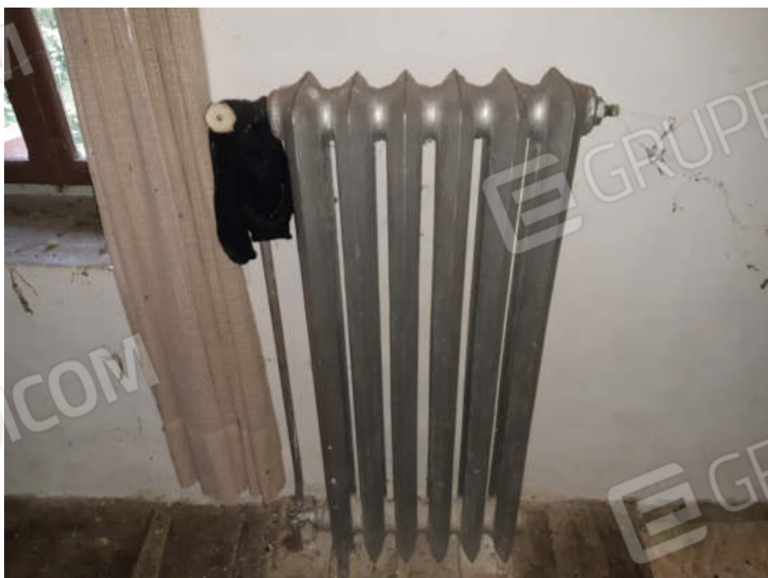
Vista particolare generatore impianto riscaldamento e tipologia batterie radianti interne
