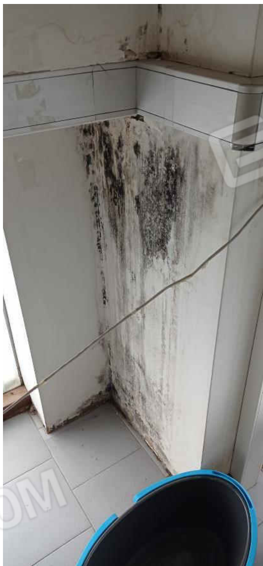
63-problematiche riscontrate a piano primo
