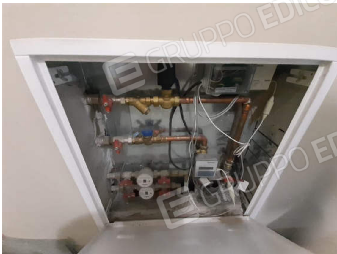
Vista particolare quadretto utenza impianto elettrico
