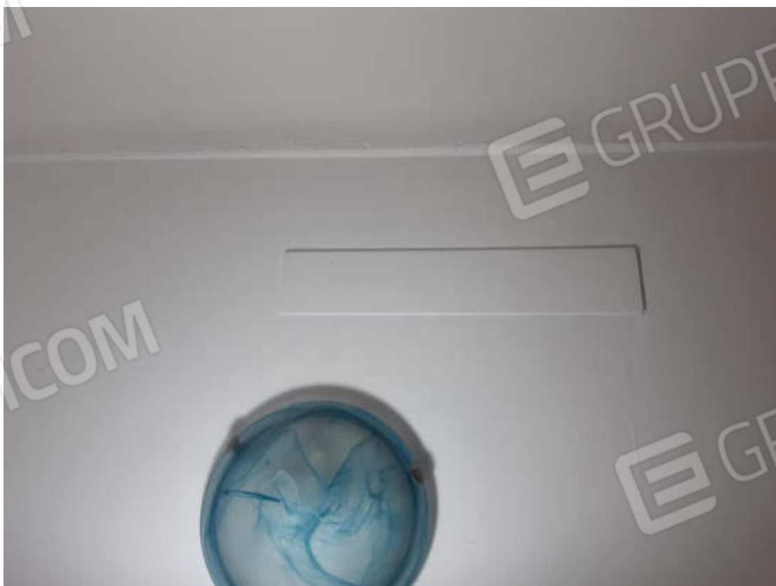
Vista particolare predisposizione impianto climatizzazione
