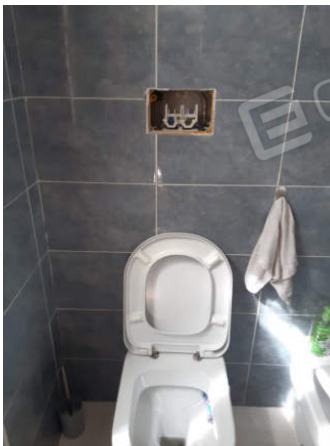
Vista particolare rottura cassetta cacciata wc
