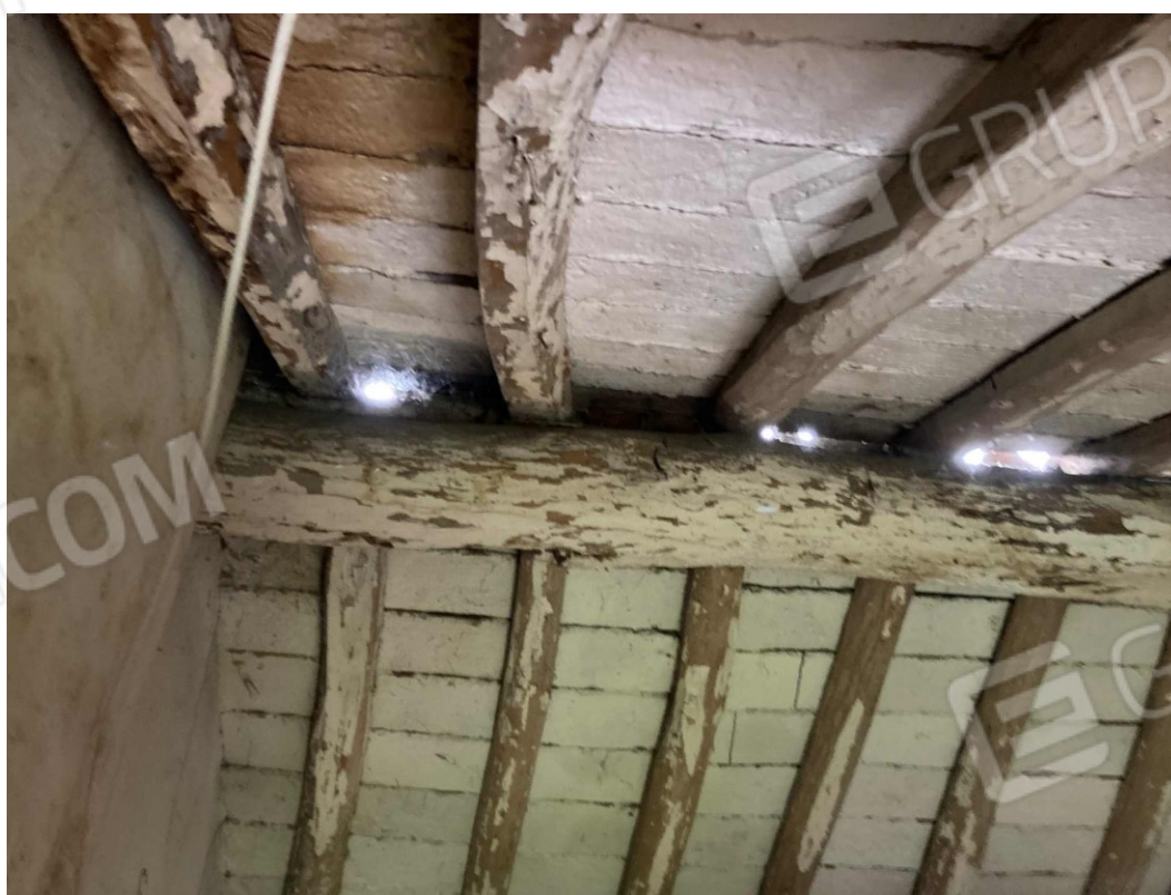
Foto 10 – Infiltrazioni dal sottotetto
