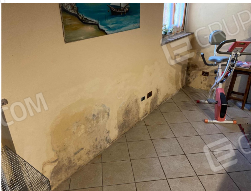
Foto 6 – Umidità di risalita al PT
