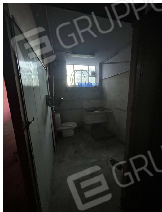
34-35. Riprese fotografiche del locale di sgombero e dello spazio lavanderia/wc ricavato in difformità al progetto depositato al piano terra
