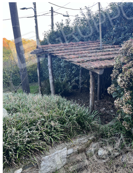
42-43. Riprese fotografiche del prospetto est e della tettoia (dalla struttura in legno molto precaria) realizzata abusivamente e che dovrà essere demolita
