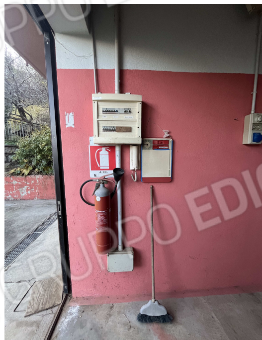
40-41. Riprese fotografiche interne del locale di sgombero (più grande) e dettaglio dell'impiantistica elettrica presente ( che evidenzia l'uso del locale)
