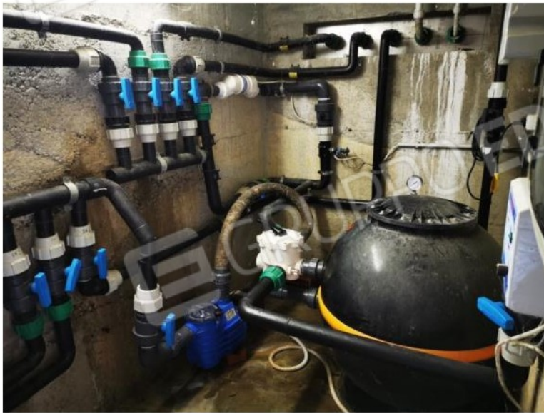
Piscina scoperta - Vano tecnico ed impiantistica
