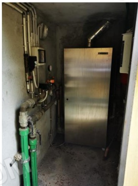
Piscina scoperta - Centrale termica
