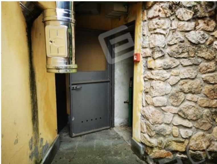
Piscina scoperta – Centrale termica
