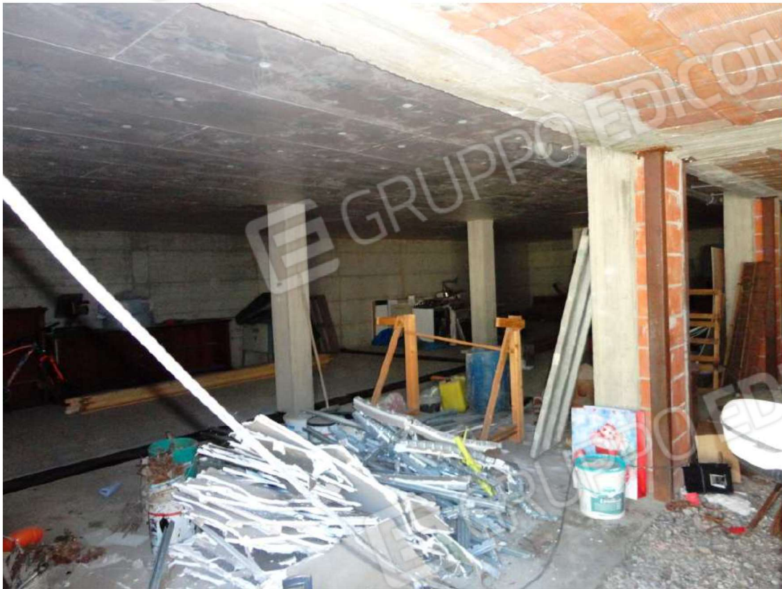
Foto 13: Vista interna dell'immobile – Piano Interrato – locale in corso di costruzione Foglio 21 mappale 1707 sub 5
