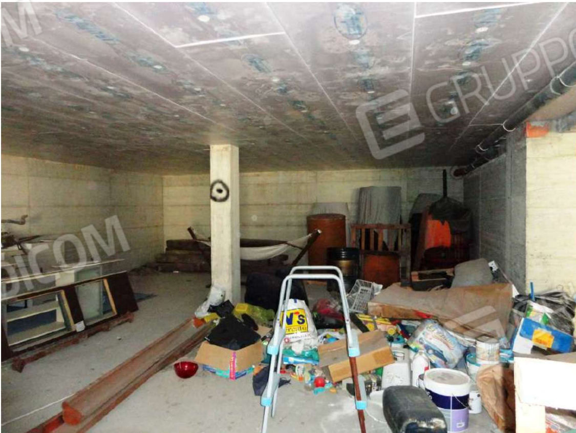
Foto 10: Vista interna dell'immobile – Piano Interrato – locale in corso di costruzione Foglio 21 mappale 1707 sub 5
