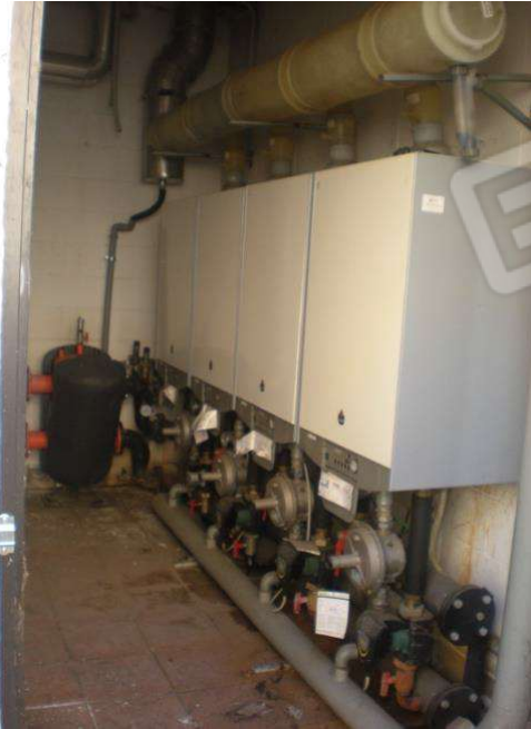
Foto 43 locale C.T. al piano terra
