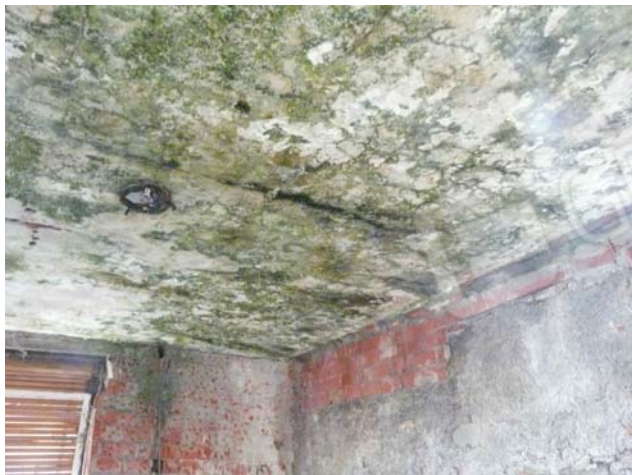
Foto 35 Intradosso solaio sub 4 piano secondo
