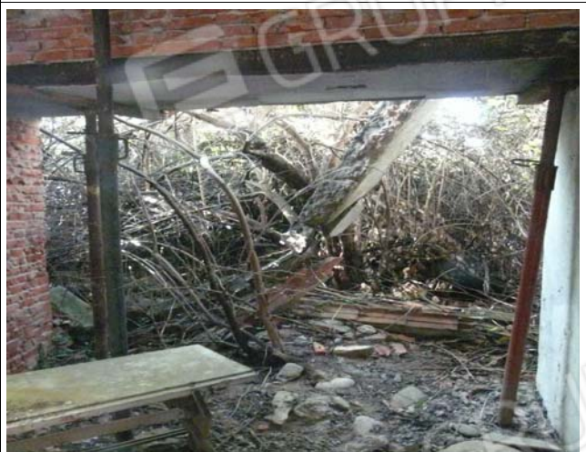
Foto 40 Facciata nord sub 8 magazzino "crollato" vista dal magazzino sub 7
