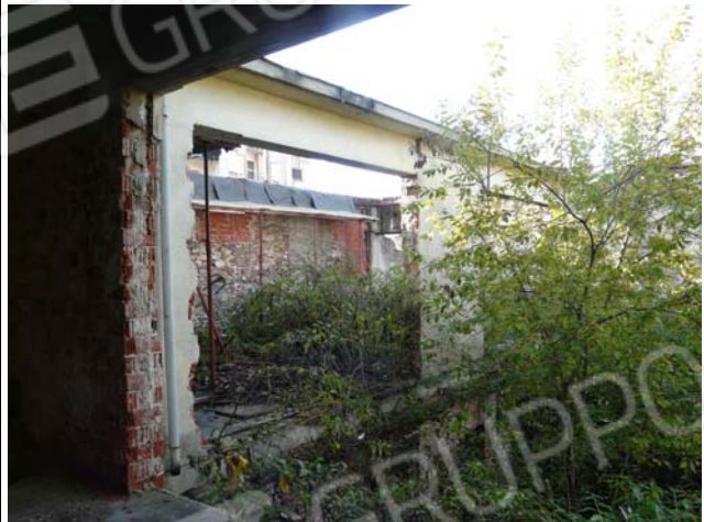
Foto 26 porzione sud magazzino sub 11 privo di solaio ,
