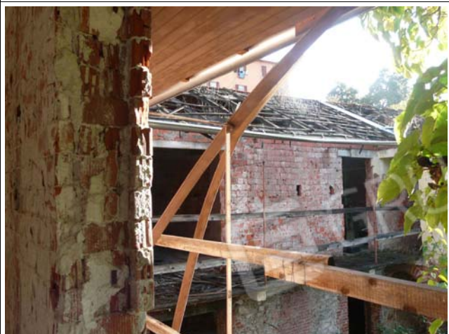
Foto 28 Facciata sud 4 secondo piano, porzione priva di copertura
