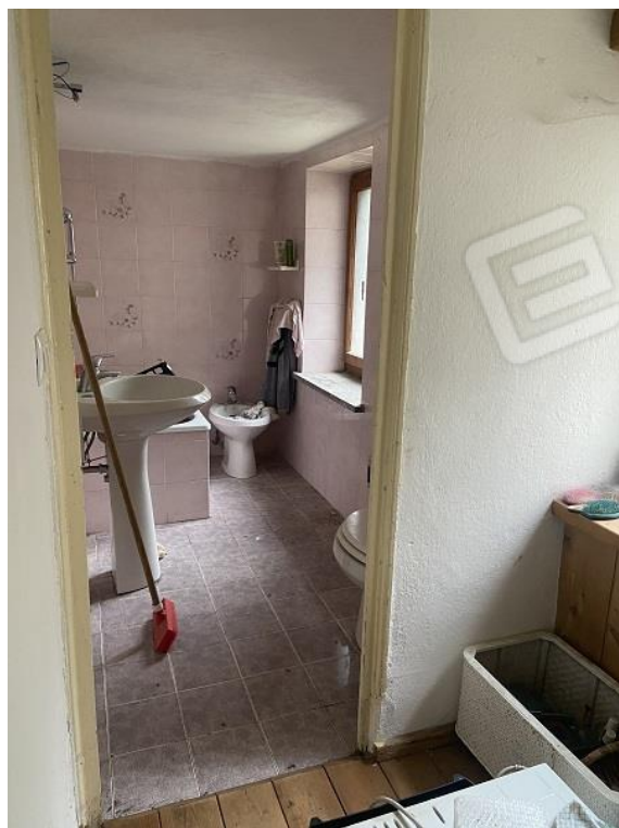
Foto 13: Prima parte di appartamento – Bagno di altezza interna pari a 1,85 m.
