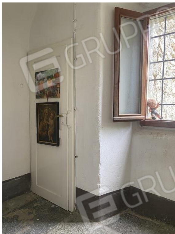
Foto 32: Porta del vecchio bagno sulla scala comune.
