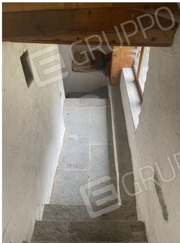
Foto 14: Prima parte di appartamento – Scala di accesso alla cantina con il portico che è stato chiuso.
