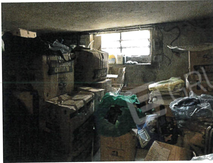
Interno box sub.2 impianto elettrico
