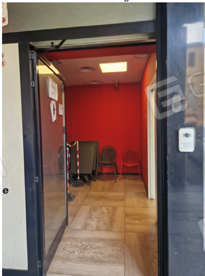
FOTO 18 dettaglio serramento ingresso
