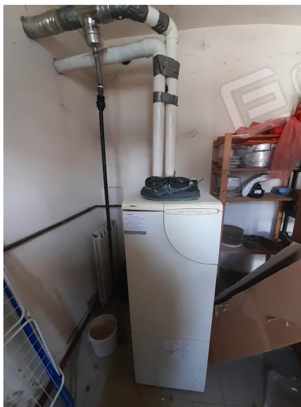
FOTO 17 – Caldaia a gas
