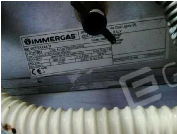
Particolare caldaia gas
