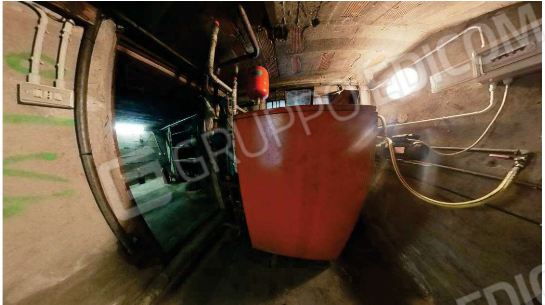
Foto 22 – Alloggio – Centrale Termica
