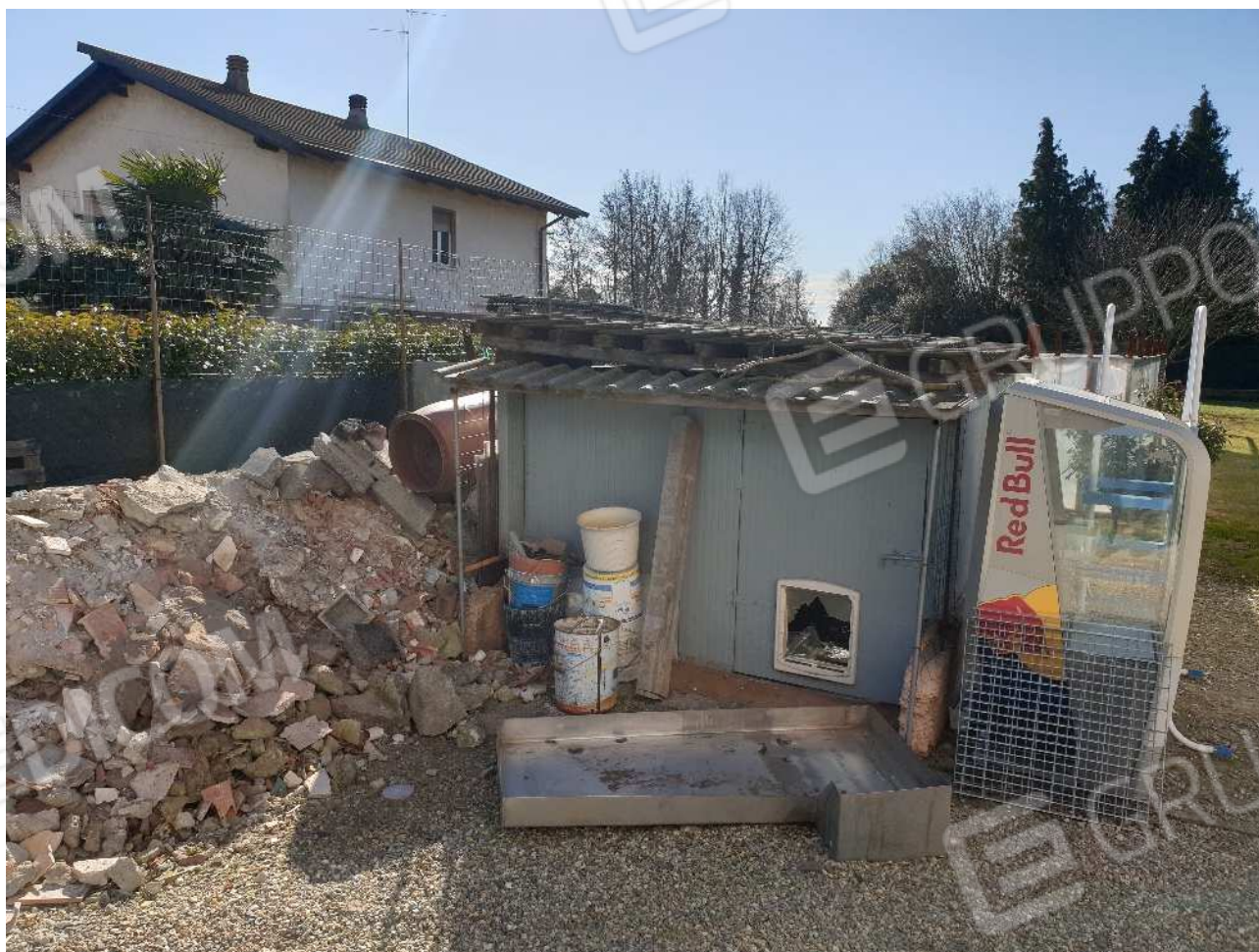
BASSIFABBRICATI ABUSIVI – BARACCA AD EST
