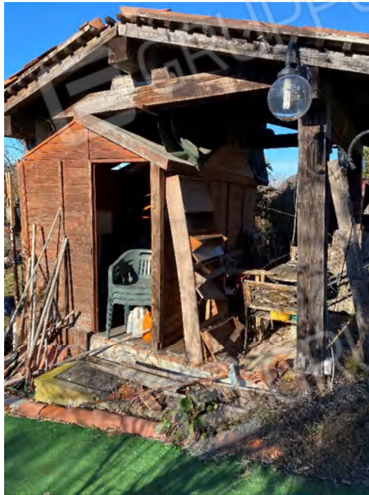
TETTOIA E CASETTA SOTTOSTANTE IN LEGNO SU BASAMENTO priva di concessione ed accatastamento
