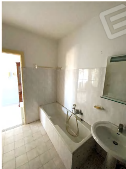
BAGNO (SUB 7) soffitto
