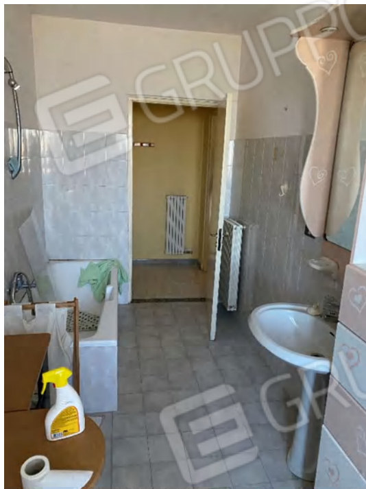
BAGNO (SUB 6) soffitto
