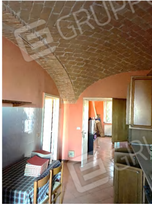
CUCINA (SUB. 5) soffitto
