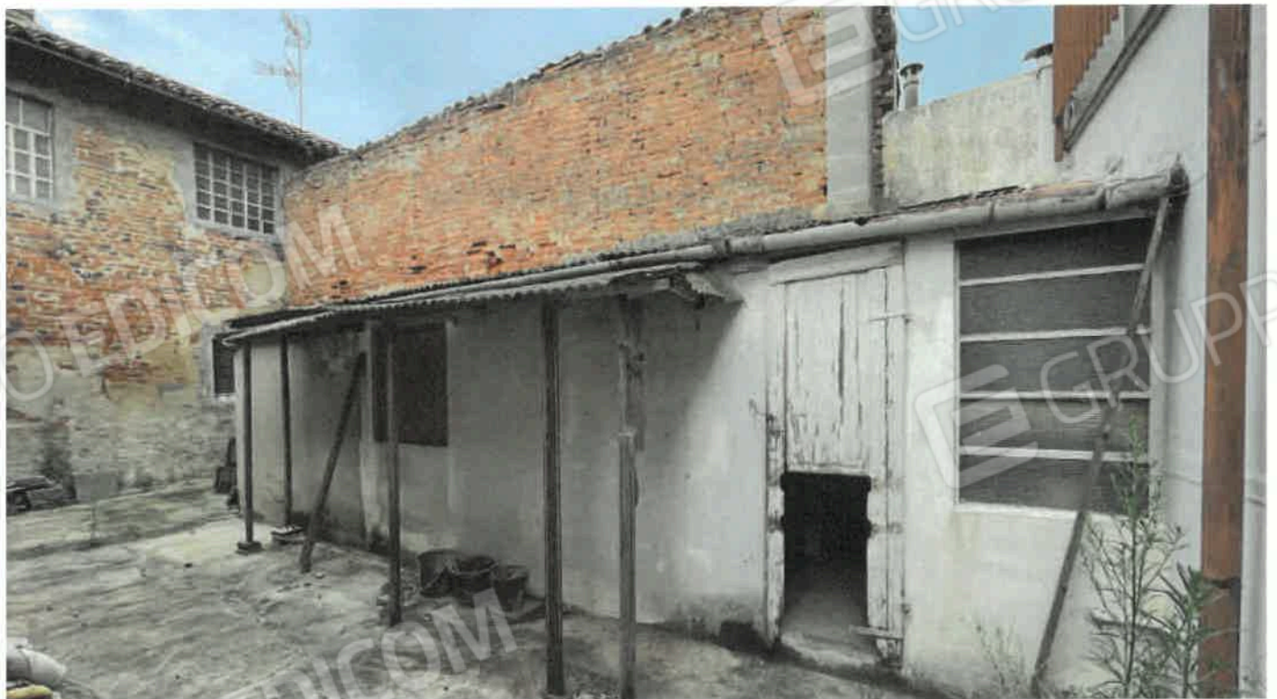
Il cortile interno su cui si affaccia il volume non accatastato e non autorizzato
