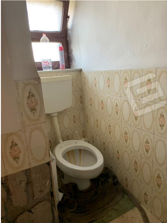
Servizio 1° piano F.8 n.348
